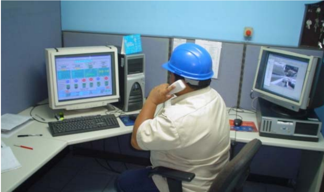
Figura 1.7 Nueva Sala de Control de Bocatoma
