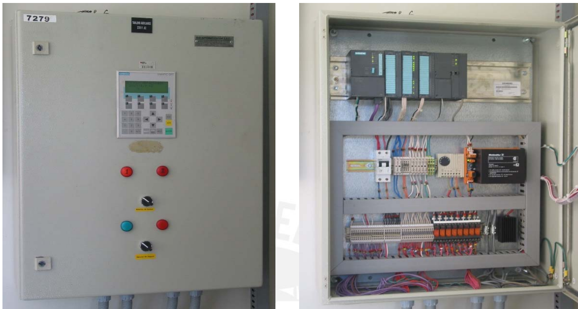
Figura 3.4 Tablero del PLC
