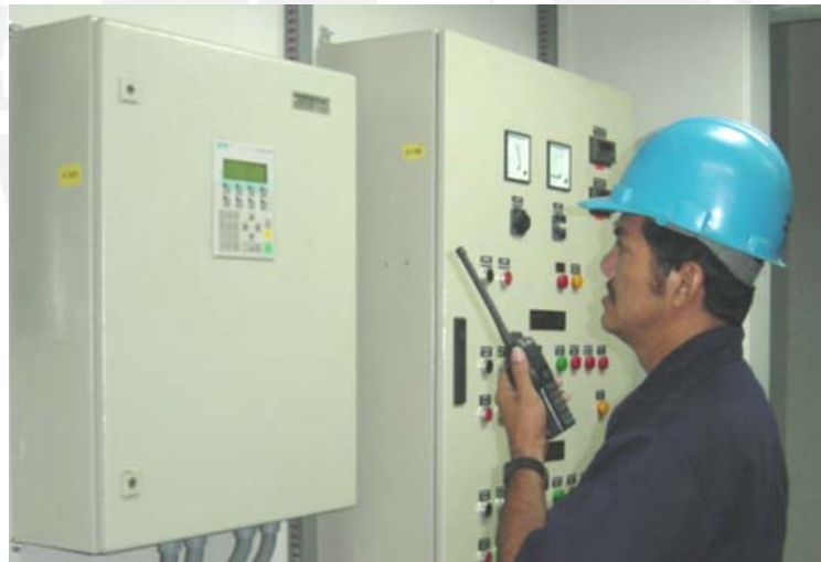
Figura 1.6 Tablero del PLC
