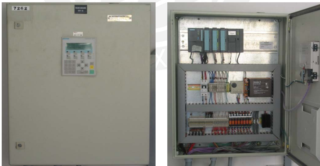
Figura 3.10 Tablero del PLC
