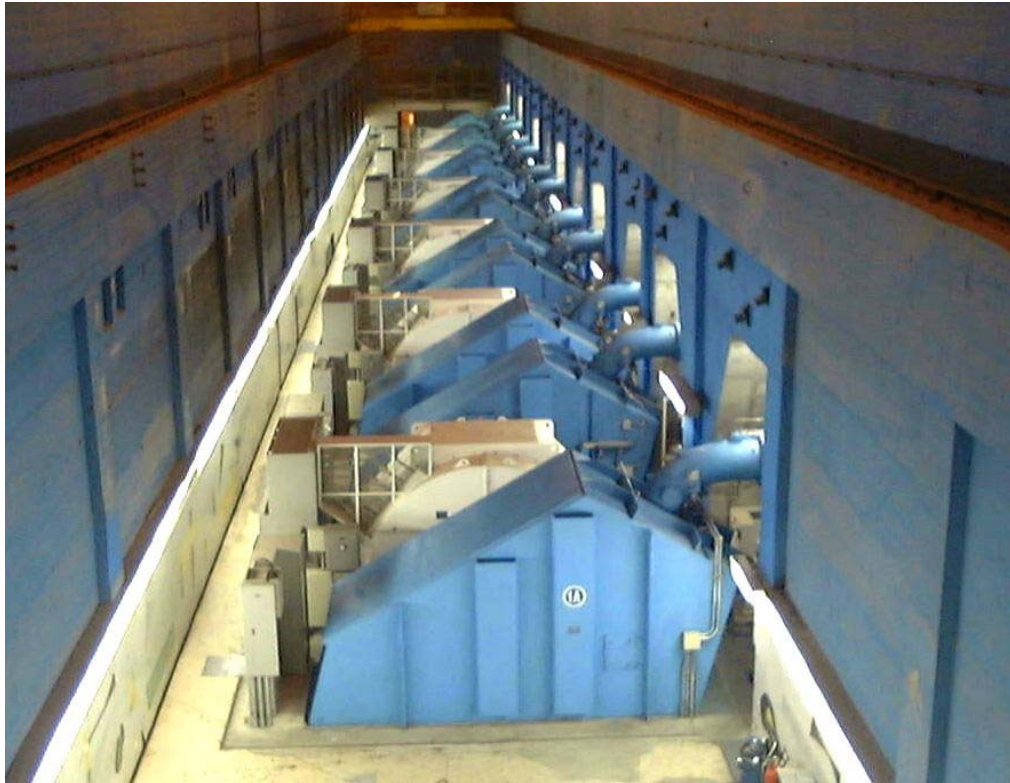
Figura 1.2 Grupos Generadores de la Central Hidroeléctrica de Cañón del Pato
