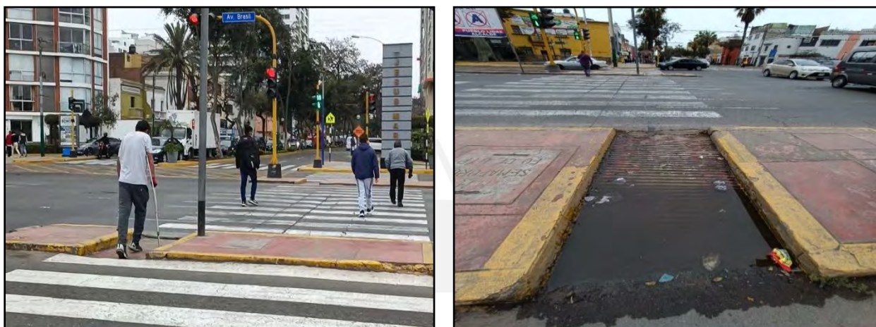
Figura 42. Hundimiento de pasos a nivel de la calzada (Fuente Propia)
