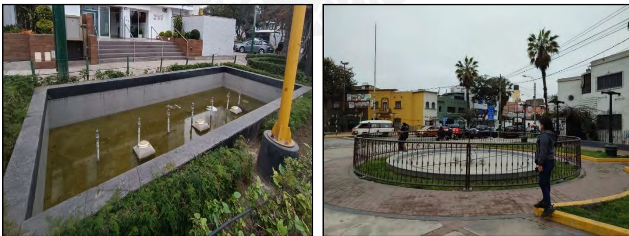
Figura 38. Piletas en estado precario (Fuente Propia)
