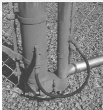
Figura 18 Ejemplo fotográfico de la equipotencialización del cerco
