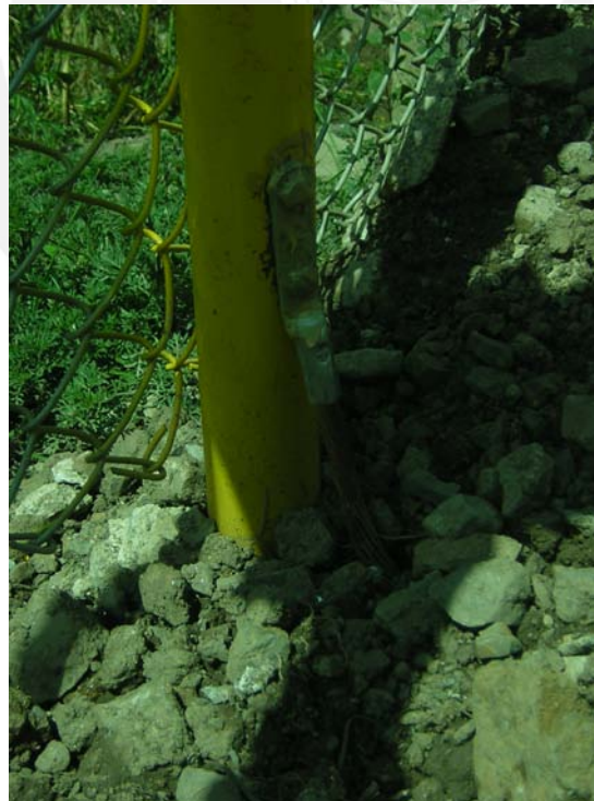
Figura 21 Equipotencialización de estructuras metálicas
