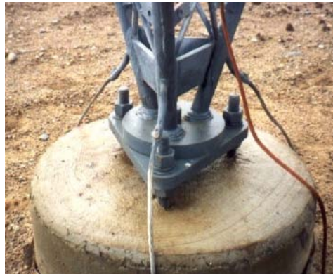
Figura 20 La estructura o torre a tierra
