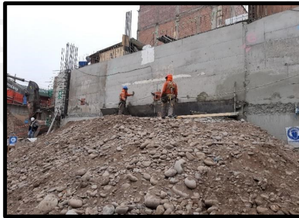
Fig 2.17. Preparación de cachimba. Fuente: Propia
