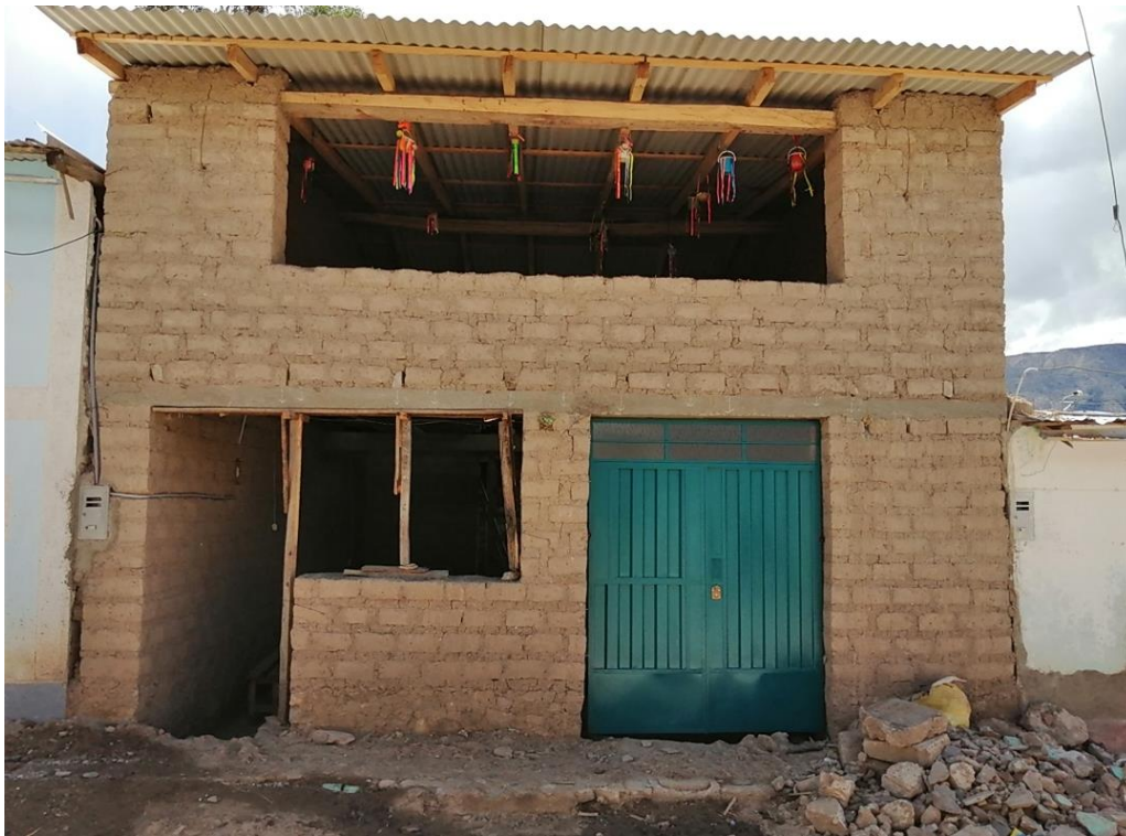
Fig. 59 Vivienda de dos niveles en Aucará en Adobe con puerta junto a ventana en primer nivel y portón, vano grande en segundo nivel que evidencia la incompatibilidad de la estructura al contar con una viga de concreto entre ambos niveles y grandes vanos que debilitan la estructura de adobe (Fuente propia, 2019)
