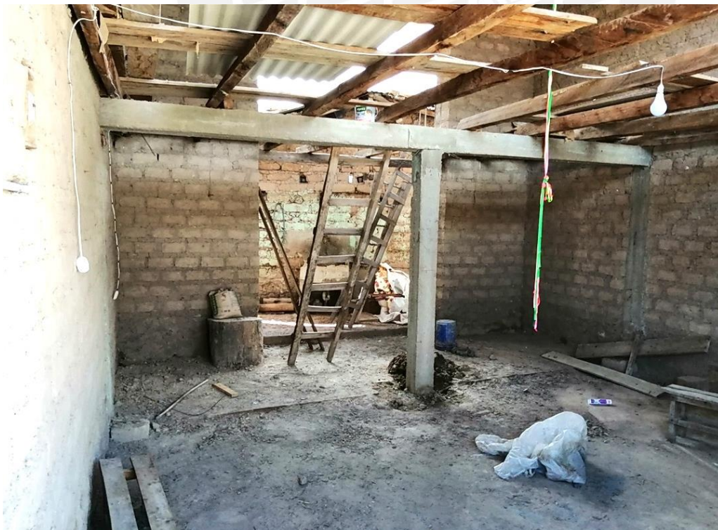
Fig. 60 Vista interior de vivienda de dos niveles en Aucará donde se evidencia la construcción en adobe con el sistema constructivo de columnas y vigas de concreto incompatibles con los muros de adobe, vigas de madera de futuro techado (Fuente propia, 2019)
