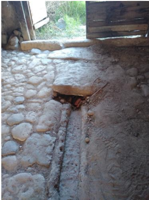
4. TAPA DE DRENAJE DE AGUA Probable rebose de agua de huerto
