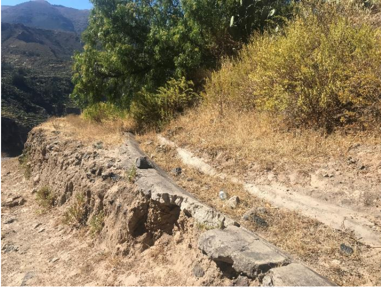
Fig. 54 Canal aun sin mantenimiento hasta siguiente siembra (Fuente propia 2019)
