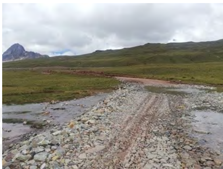
Figura 25: Tramo de la carretera con problema de deterioro por acumulación de agua
