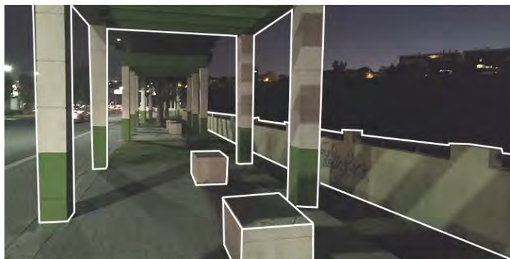
SIN ILUMINACIÓN A NIVEL PEATONAL
