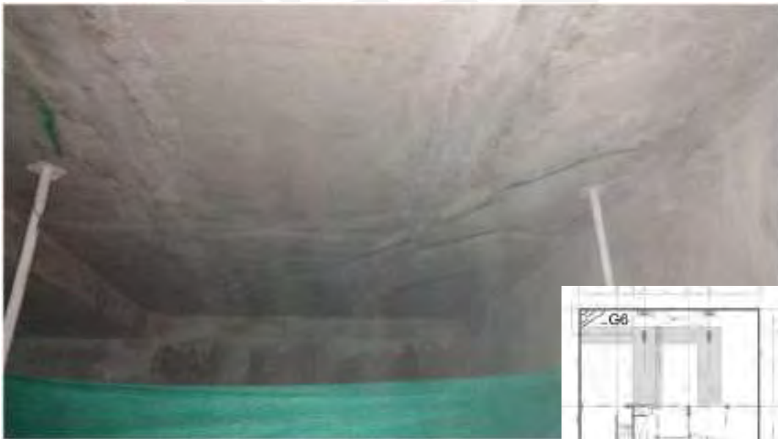
Figura 5.33: Grupo de Fisuras G6
