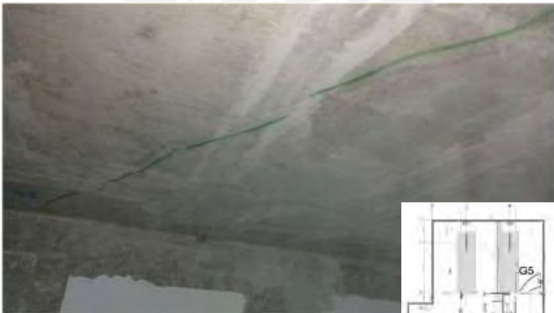
Figura 5.27: Grupo de Fisuras G5 (1)
