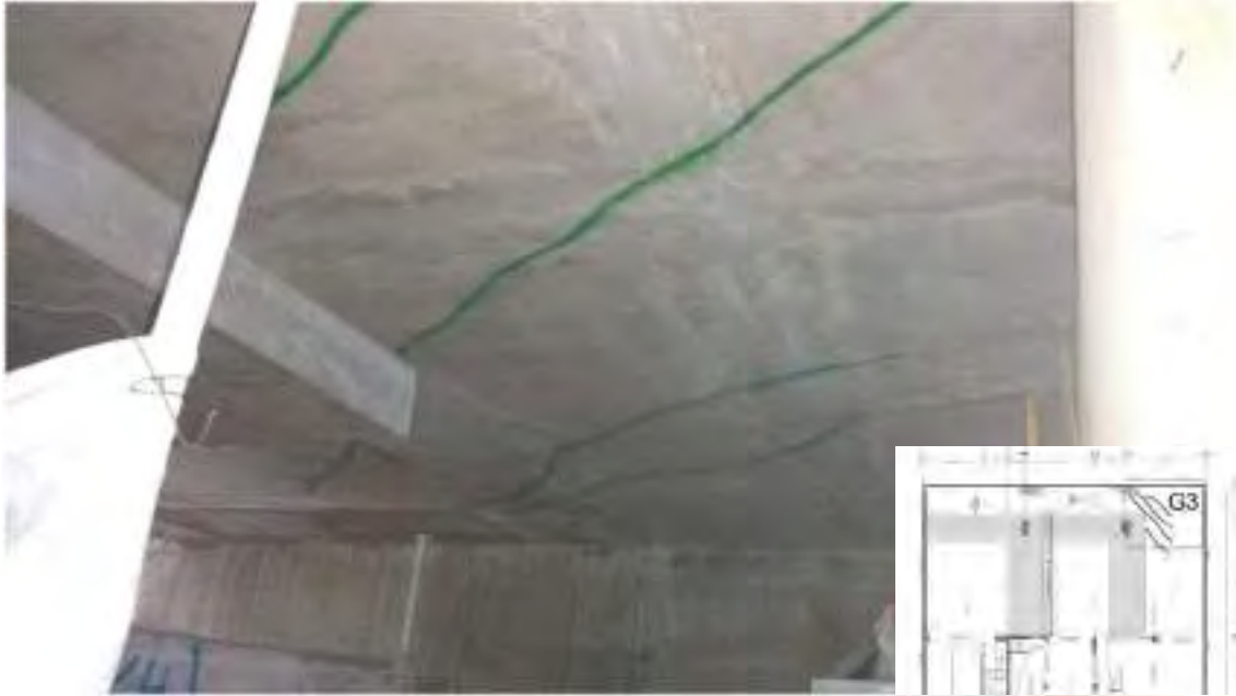
Figura 5.21: Grupo de Fisuras G3
