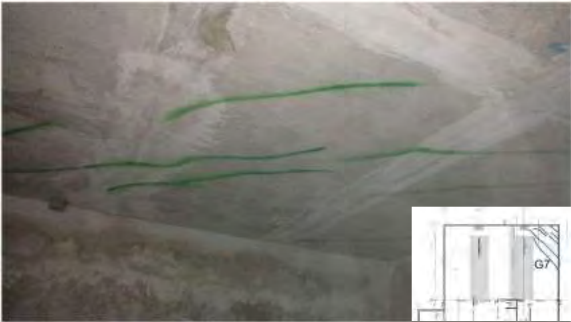
Figura 5.38: Grupo de Fisuras G7 (1)
