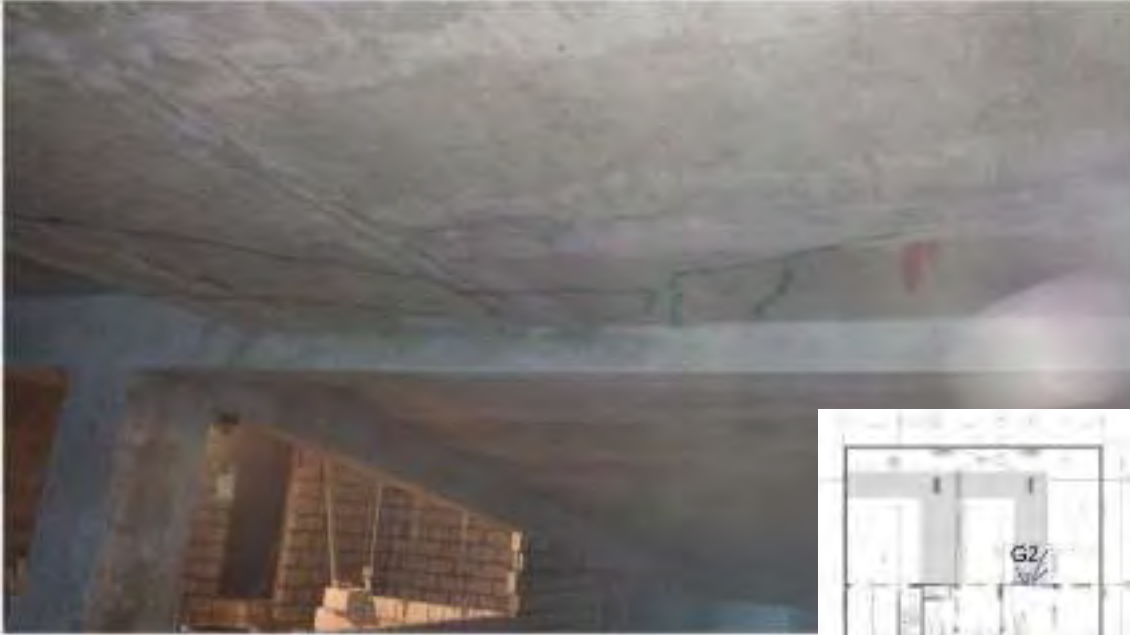
Figura 5.19: Grupo de Fisuras G2
