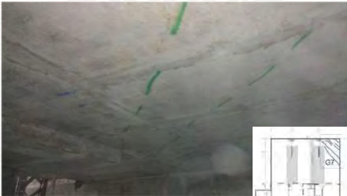
Figura 5.39: Grupo de Fisuras G7 (2)
