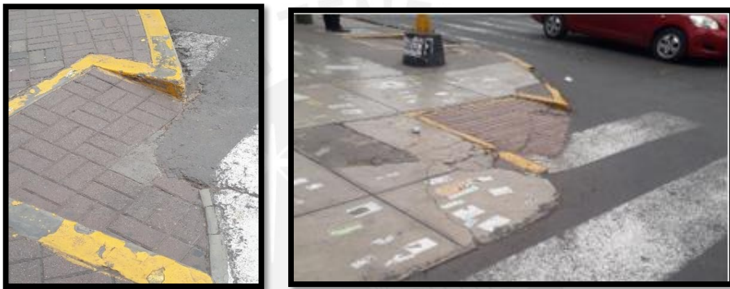
Figura 3.4. Rampas con grietas y de material inadecuado.
