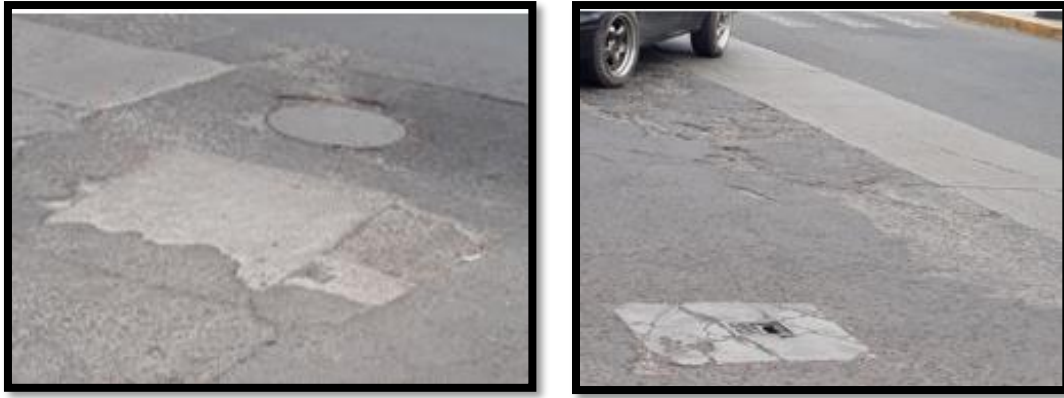
Figura 3.3. Calzada en mal estado.
