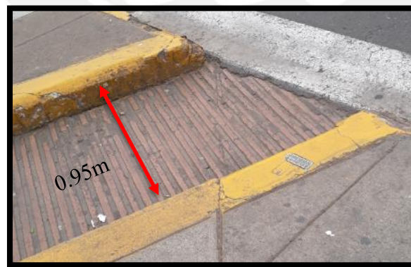
Figura 3.5. Ancho inadecuado para el paso una silla de ruedas.
