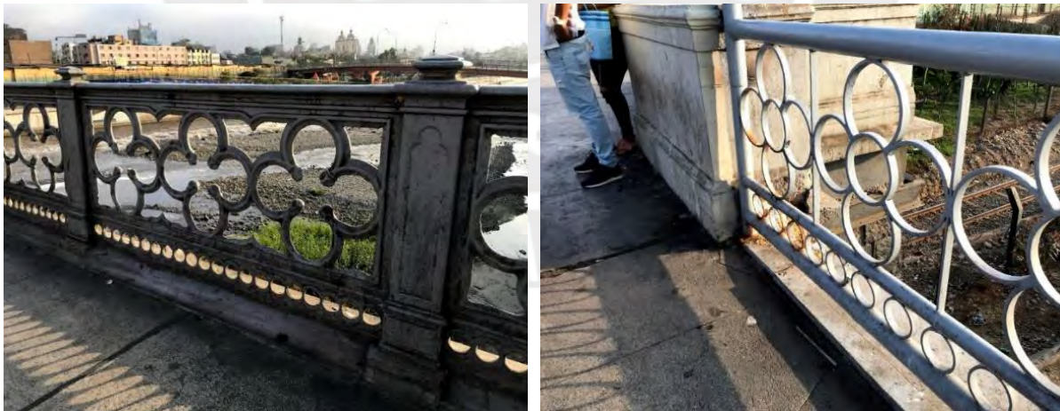
Figura 12 y Figura 13: Estado de barandas.
