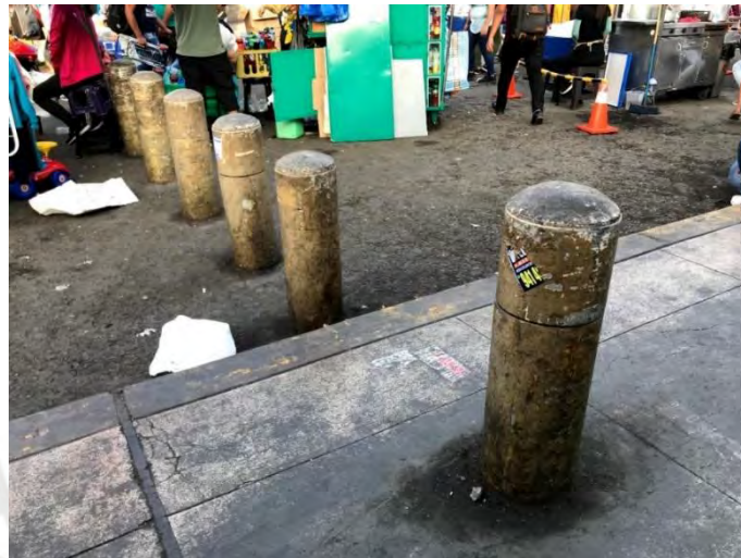
Figura 14: Estado de bolardos.
