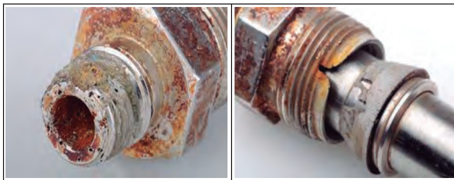
Figura 1.2. Conectores corroídos. Fuente: parker.com
