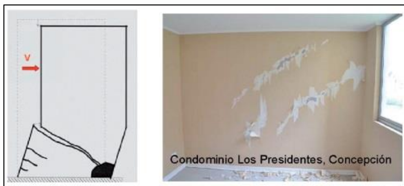
Figura 3.26 Falla por corte observada en un edificio chileno
