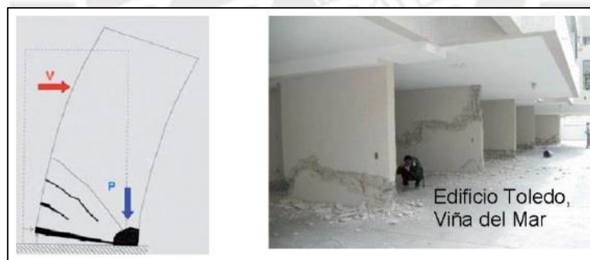
Figura 3.25 Falla por flexión observada en un edificio chileno
