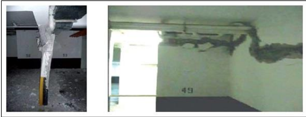
Figura 3.28 Falla horizontal observada en un edificio chileno
