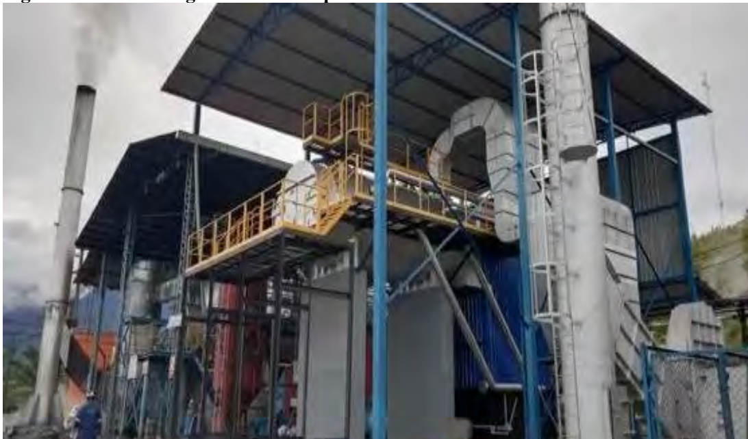
Figura Z10: Caldero generador de vapor
