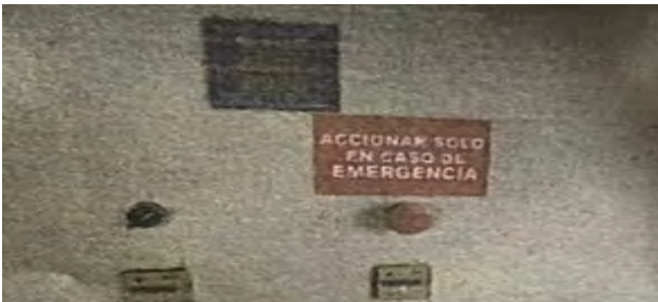
Figura 40. Señalización: Botón de Emergencia
