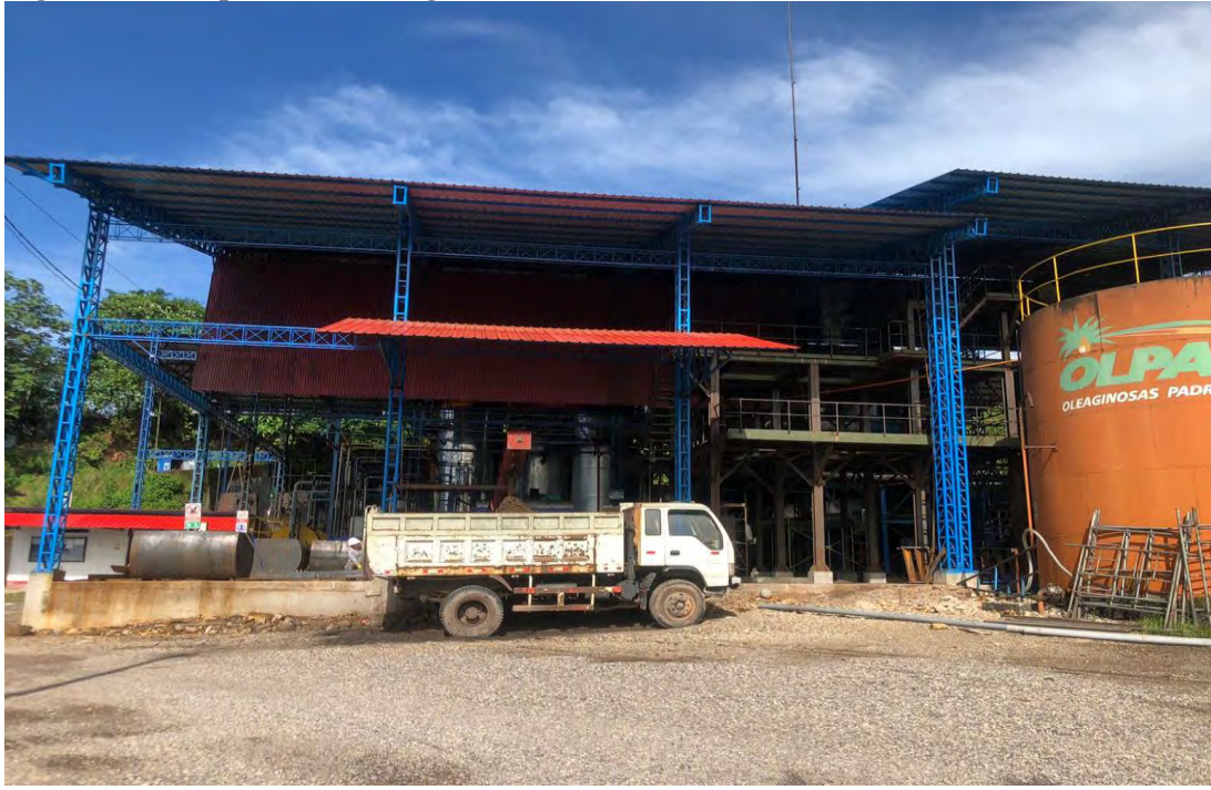
Figura Z5: Maquinaria de cargamento de lodo
