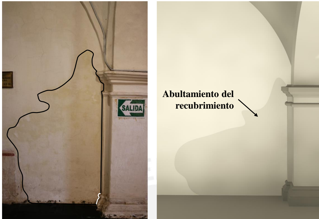
Fig. 4.22 Representación del abultamiento del recubrimiento en muro de la cripta
