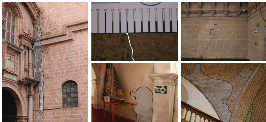
Fig. 4.10 Patologías estructurales encontradas en la iglesia
