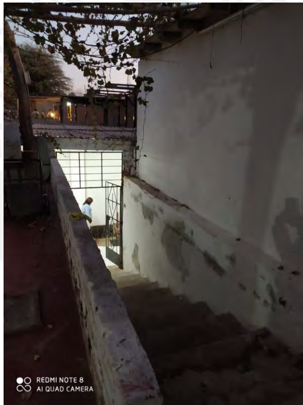
Figura 37: Falta de señalización de las áreas de trabajo
