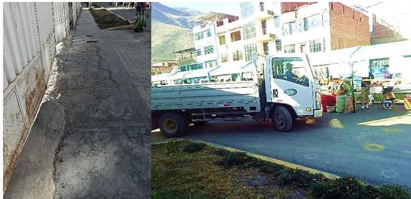
Figura 30. Veredas en mal estado a causa de la carga de vehículos pesado
