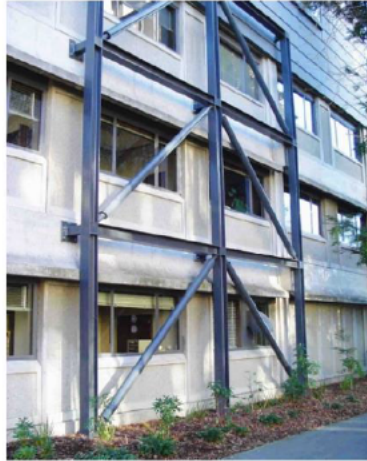
Figura N°8. Vista pórtico arriostrado de acero para rehabilitación de estructura existente de concreto armado
