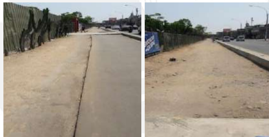
Figuras 4.18 y 4.19: Superficie inadecuada para el tránsito de peatones
