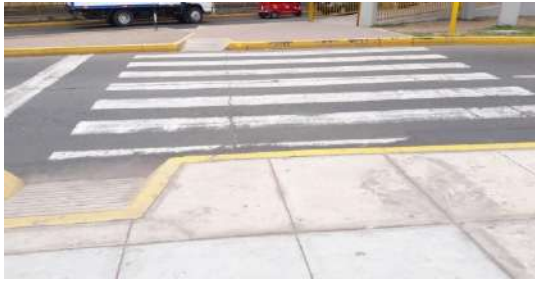
Figura A2.6: Grietas en el pavimento del cruceo peatonal N°7
