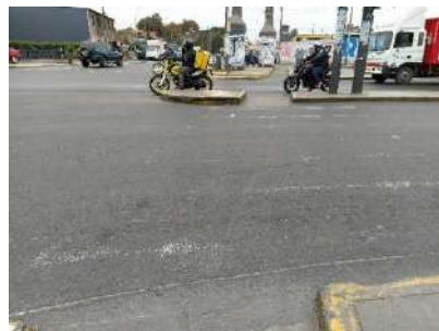
Figura 4.53: Cruceo peatonal N°4 despintado
