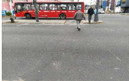
Figura 4.51: Cruceo peatonal N°3 despintado
