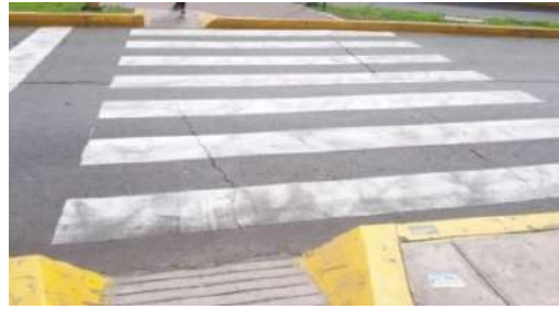
Figura A2.7: Presencia de grietas en el pavimento del cruceo N°4
