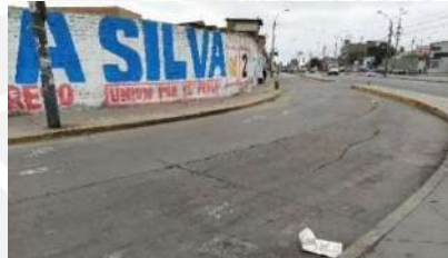
Figura 4.52: Cruceo peatonal N°5 despintado
