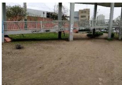
Figura 4.28: Áreas verdes sin mantenimiento en la isla canalizadora izquierda
