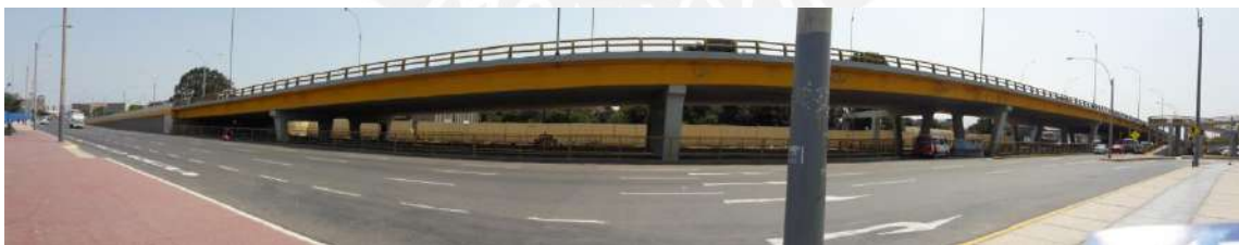
Figura 4.33: Foto panorámica donde se aprecia los miles de metros cuadrados debajo de la calzada elevada
