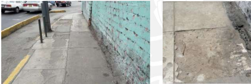
Figura A2.16 y A2.17: Vereda en mal estado
