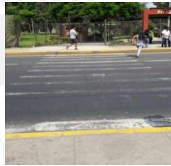
Figura 4.22: Cruce inseguro sin rampas de acceso
