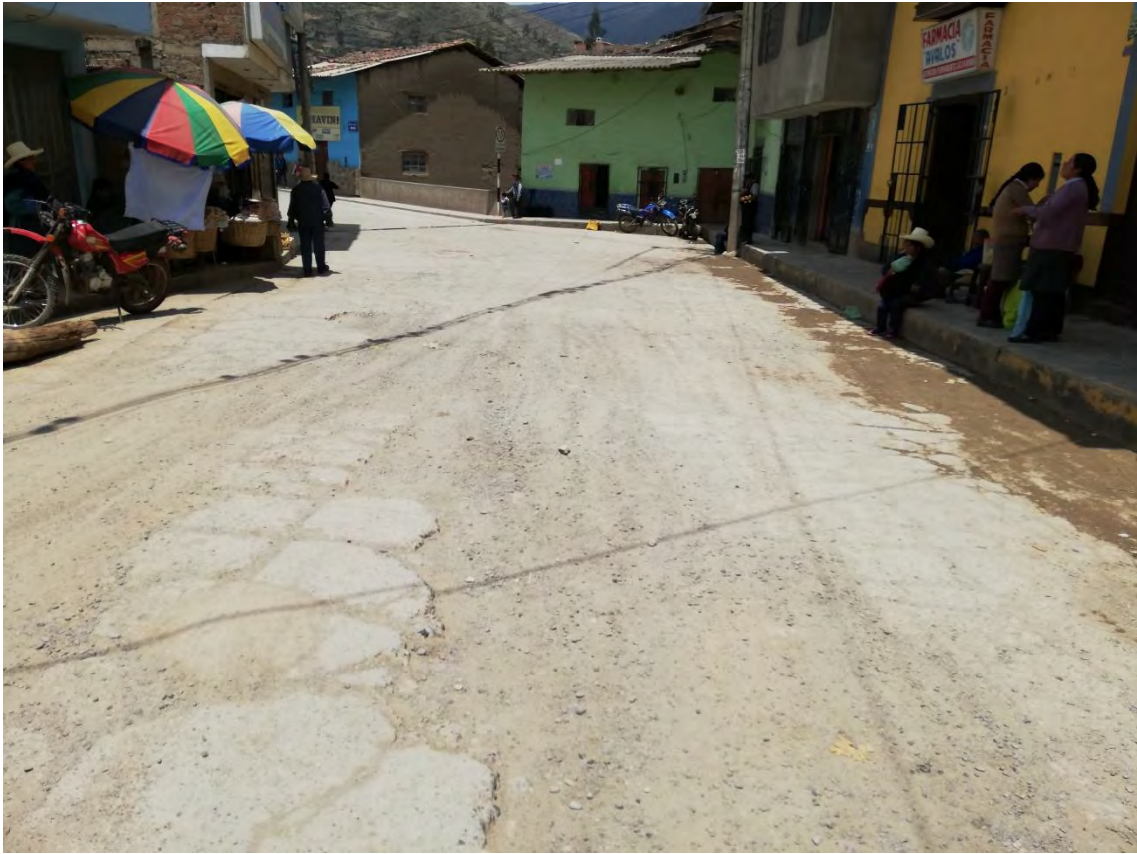
Foto 2. Calle maltratada por la mala evacuación de lluvias
