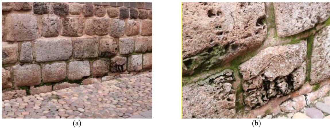
Figura 4.6 Presencia de patologías biológicas en la cara exterior del muro de la Capilla de Loreto, (a) decoloración y (b) erosión en la piedra.
