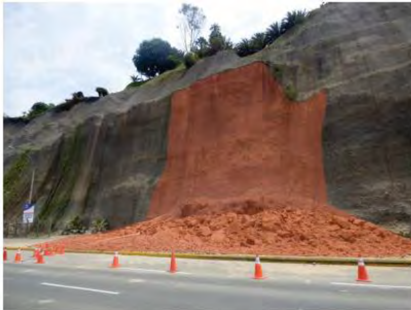
Figura 2.2: Derrumbe ocurrido en la Costa Verde, distrito de Barranco (INGEMMET, 2020).
