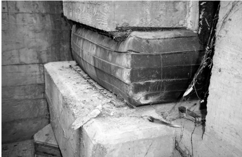
Figura 2.4: Aislador no reforzado en el edificio de la escuela Pestalozzi en Skopje. (Kelly 2011).
