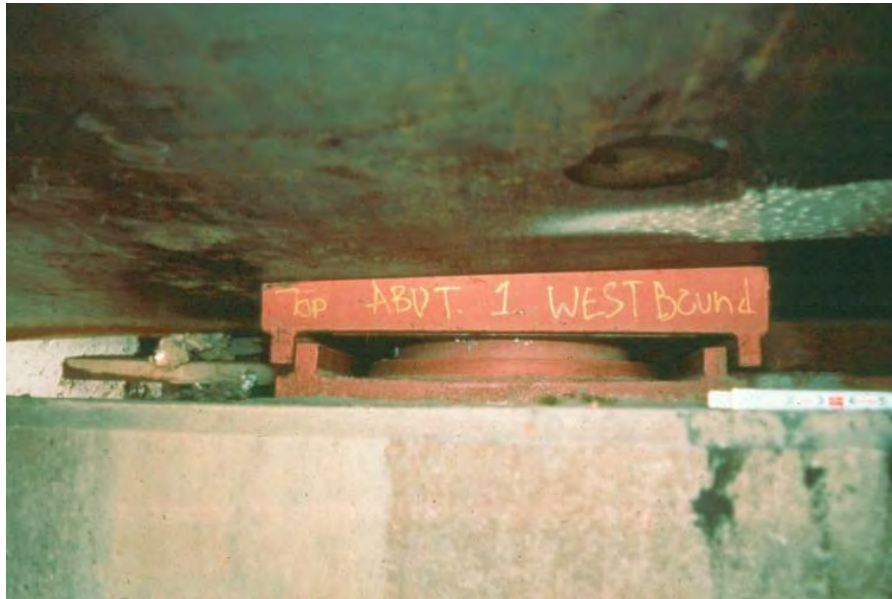
Figura 2.7: Aislador de acero guiado ubicado entre la sub y superestructura del puente.
