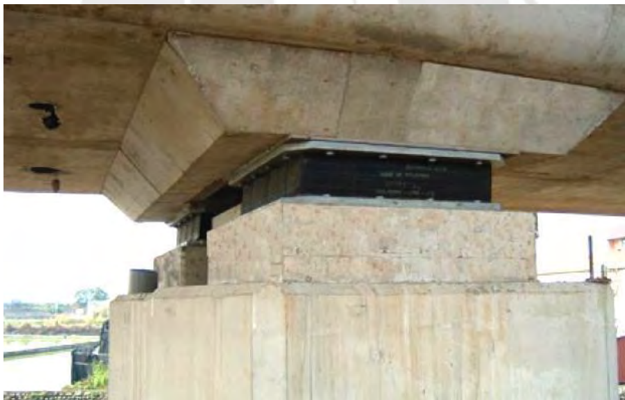
Figura 2.8: Aislador elastomérico LRB ubicado entre la sub y superestructura del puente.
