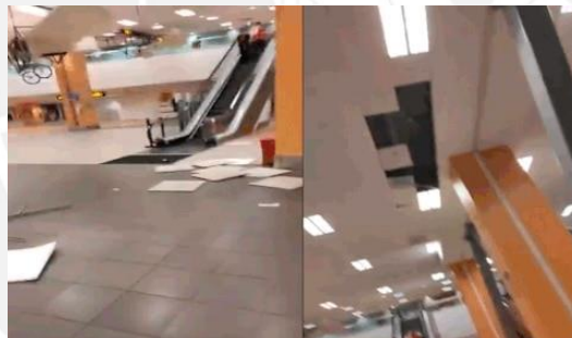
Figura 1.1 Daños en el Falso techo del Aeropuerto Jorge Chávez (La república, 2021)
