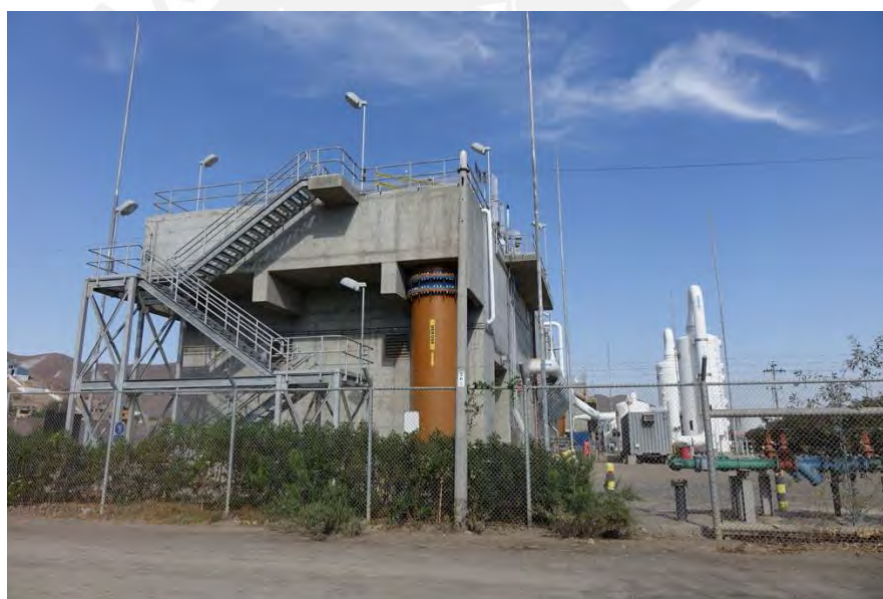
Fotografía registrada el 8 de noviembre del 2018.
