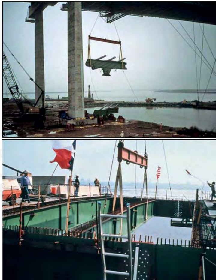
Figura 4.4.1-6: Puente Baytown: Izaje de segmento extremo de viga, la cual se une a los pilares extremos y en la cual se colocan los cables posteriores de anclaje (arriba) y colocación del tramo de cierre central (abajo) (Svensson, 2012)
