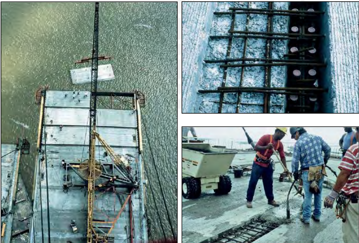
Figura 4.4.1-5: Puente Baytown: Instalación de paneles de concreto prefabricado (izq.), junta entre paneles (der., arriba) y vaciado de concreto vaciado en sitio en las juntas (der., abajo) (Svensson, 2012)
