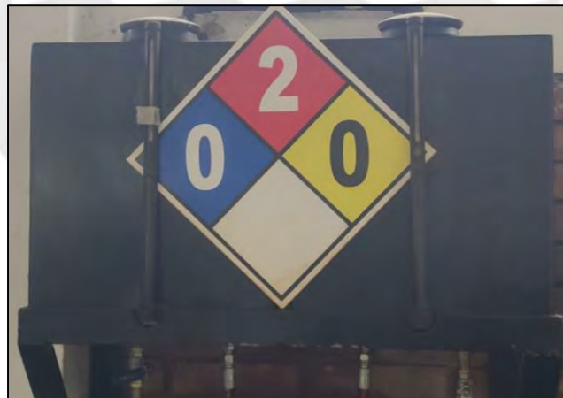
Figura 13 - Tanque de combustible.
