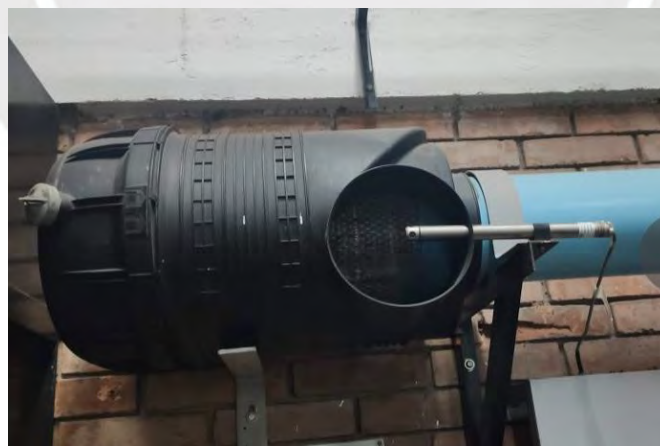
Figura 19 - Sensor de humedad relativa y temperatura instalado en el filtro de aire.
