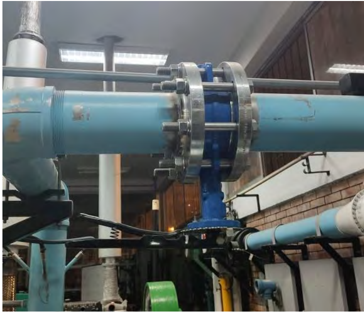
Figura 15 - Válvula mariposa de restricción de aire.
