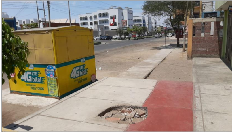
Figura 28. Estado de las veredas. Fuente: propia.
