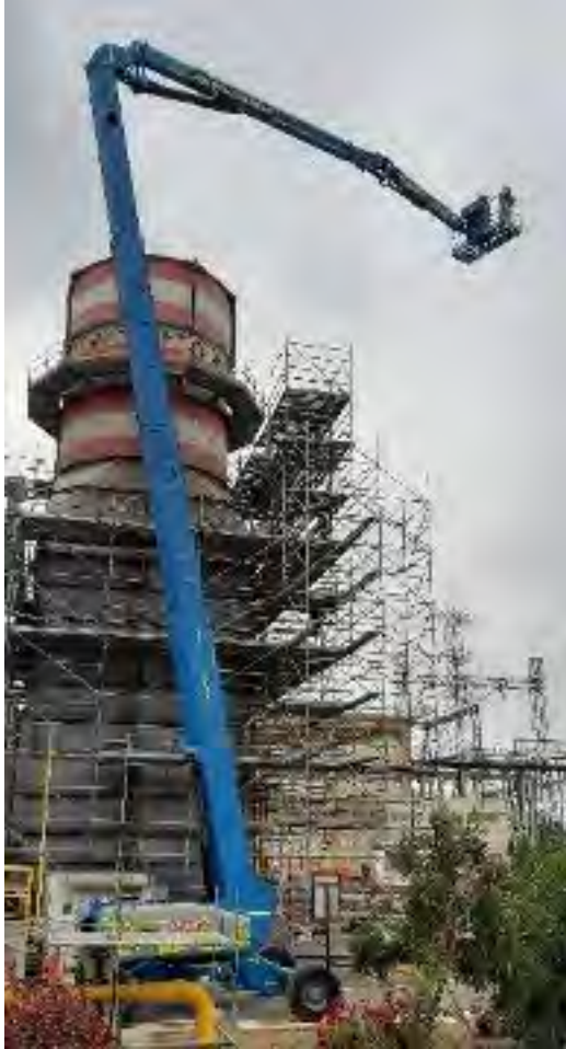
Fotografía 5.12.- Maniobras con manlift durante el proceso de instalación de elementos de izaje
