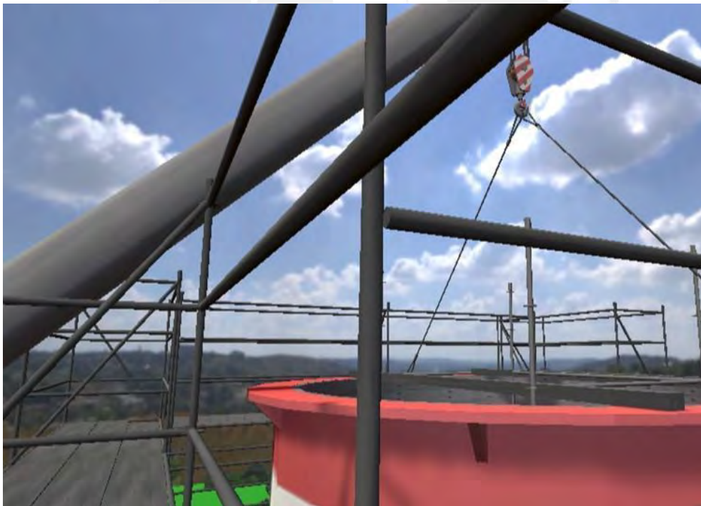
Figura 4.16.- Sesión de aprendizaje de actividad 2, preparación para el izaje de la zona superior de la chimenea
