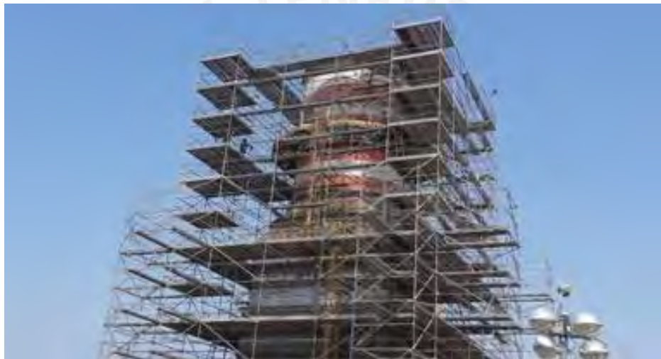
Fotografía 5.10.- Colaboradores trabajando en los andamios de la chimenea de la unidad TG8
