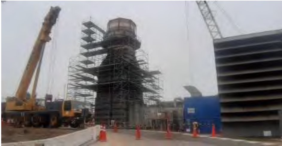
Fotografía 5.9.- Maniobras de izaje con grúa secundaria durante el proceso de reemplazo de silenciadores
