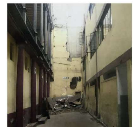
Depósito de concreto que obstruye el segundo patio
