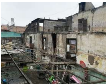
zona en peligro de colapso
