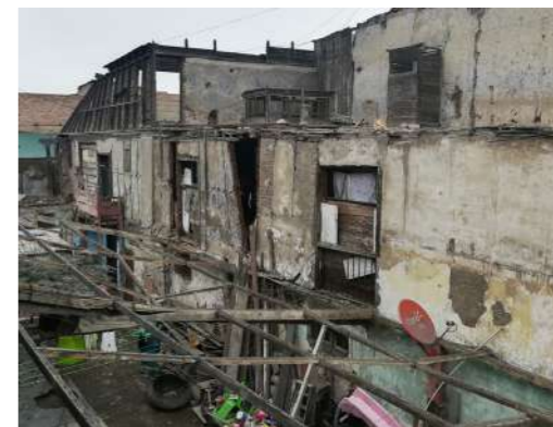
Volumen con cuartos pequeños y en peligro de colapso
