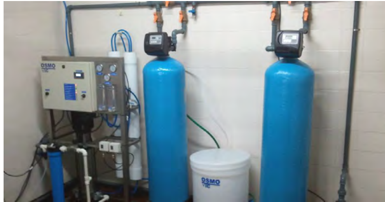
Figura C7: Planta de tratamiento de agua
