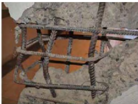
Figura 2.2: Pérdida de sección en el muro de concreto. Tomado de Wallace et al., 2012.
