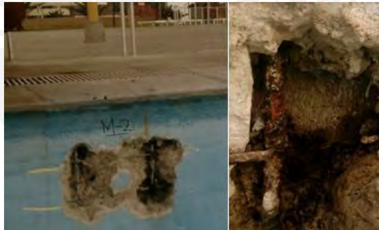
Figura 3. 6 Corrosión severa de la barra de acero del muro de contención de la piscina del Club CAFAE-SE, Punta Hermosa.
