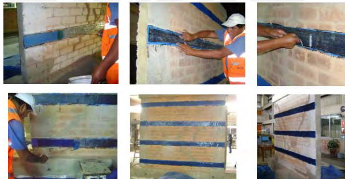
Figura 2. 22 Fibra de carbono en muros de confinamiento. Nota: Recuperado de la Tesis de Coronel C. (2009): Fibra de Carbono en elementos estructurales. Pontificia universidad Católica del Perú, Lima, Perú.
