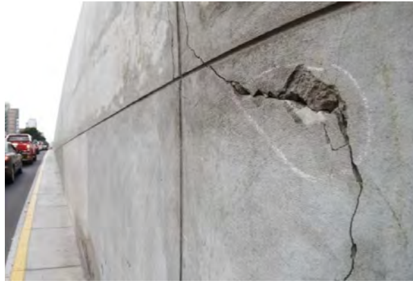
Figura 3. 5 Grieta ubicada en el muro de contención del By Pass 28 de julio.
