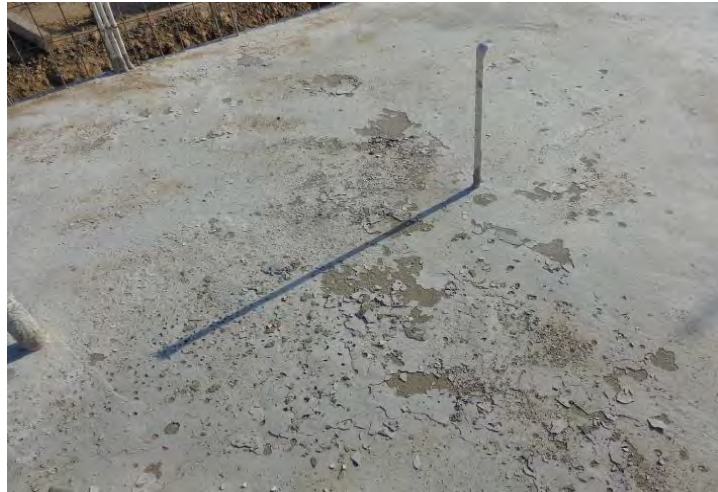
Figura 3. 9 Delaminación de una losa de concreto. Nota: Recuperado del curso Tecnología de Concreto-PUCP, 2011.
