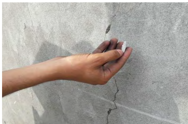
Figura 3. 4 Fisura ubicada en el muro de contención del By Pass 28 de julio.
