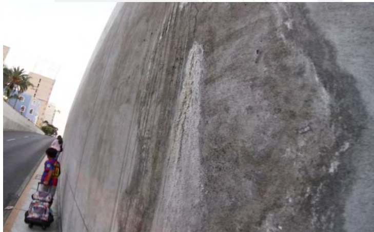
Figura 3. 8 Eflorescencia en muro de contención del By Pass 28 de julio.
