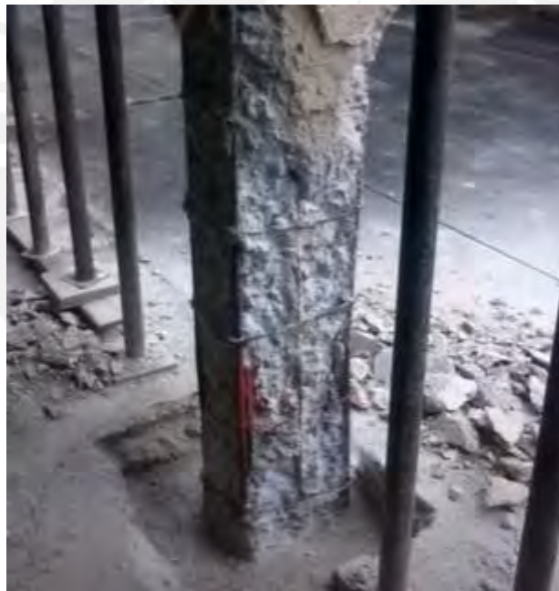
Figura 2.13 Columna de concreto armado sin recubrimiento.
