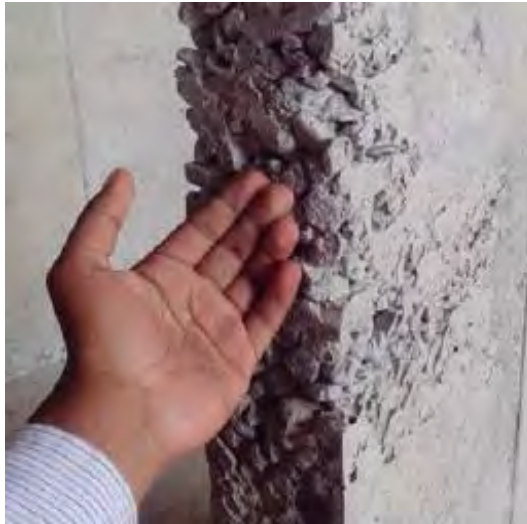
Figura 3. 7 Cangrejera en muro de concreto armado.
