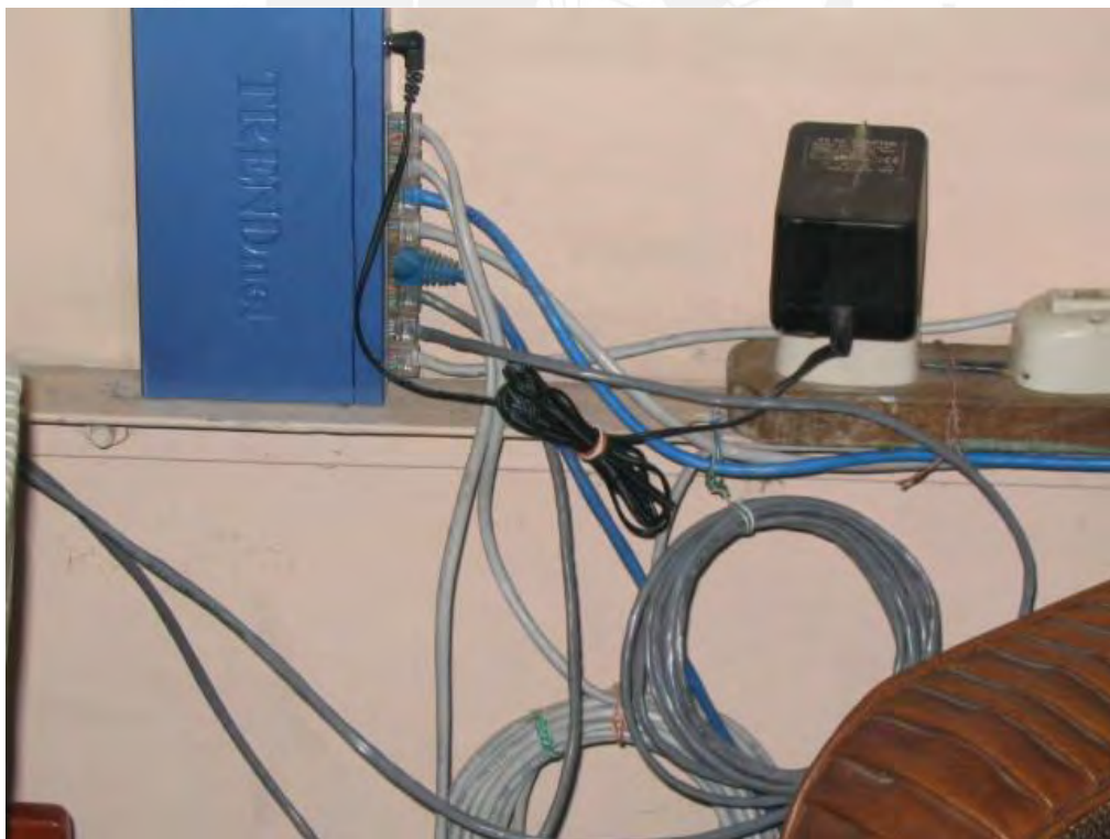
Switch TRENDNET de 8 puertos del Dpto. de integración. Conectado al SW de almacén.
