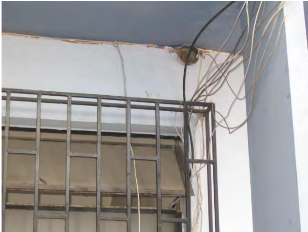
Area de Emergencia, acometida de la FO. Y distribución en UTP hacia las oficinas.
