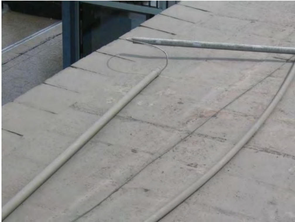
Tendido de cable UTP sobre la dirección medica, utilizaron 1 tubo de 1" para 1 solo cable.
