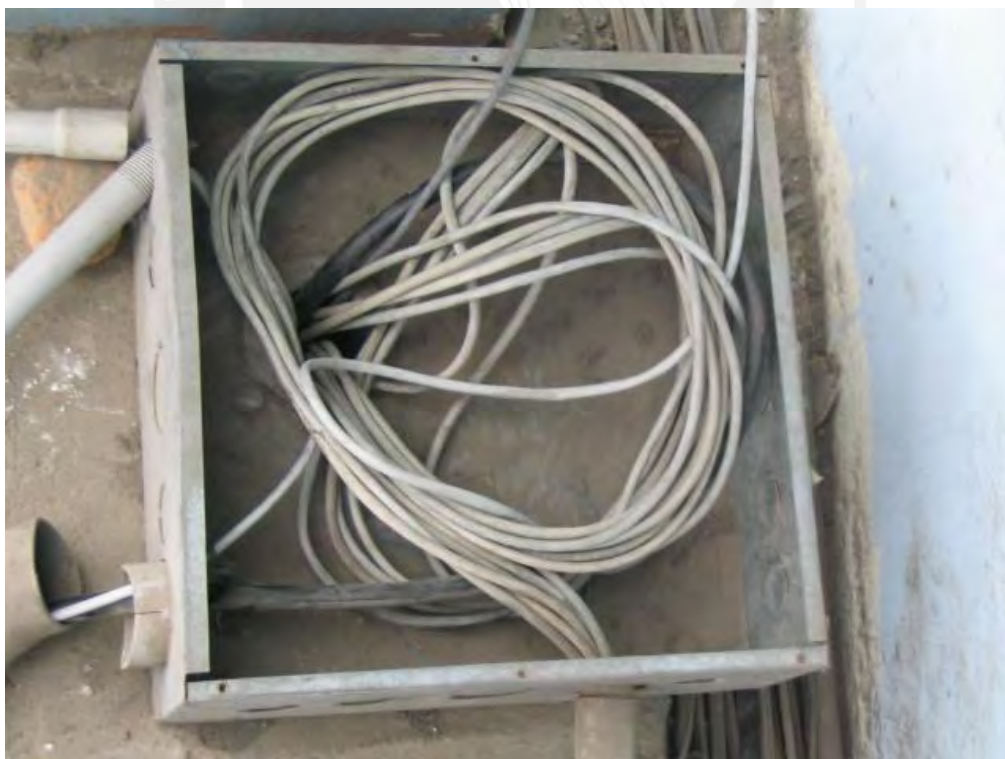
Otra vista del mismo lugar pero con la tapa de la acometida retirada.
