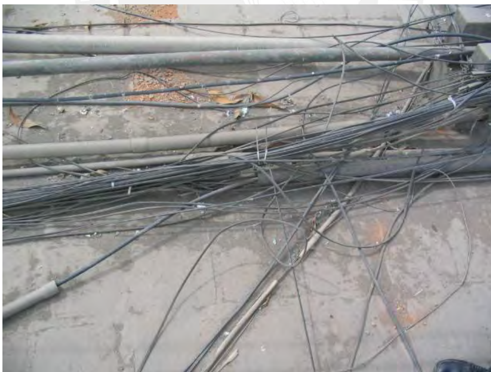
Cables de datos y de telefonía, ambos tendidos sobre el techo de pediatría
