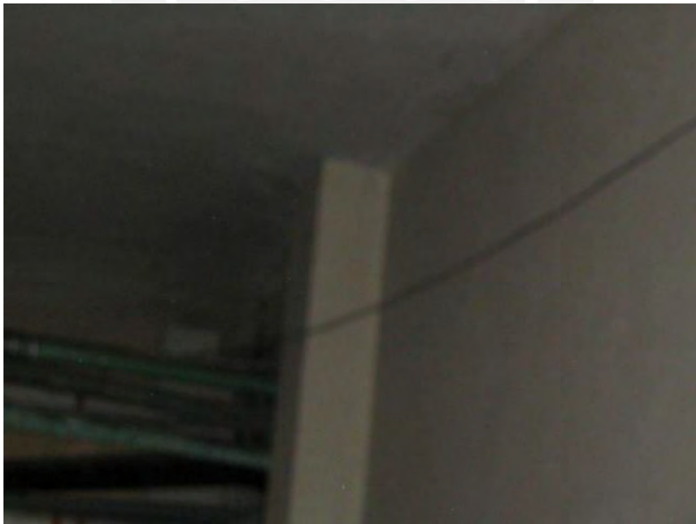
Tendido de cable UTP a través de la lavandería que viene desde Almacén hacia Patrimonio.
