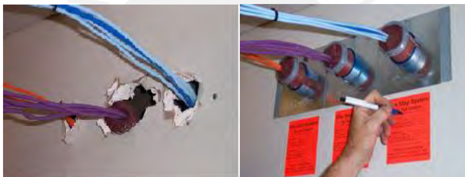
Figura 4.25 Antes y después de una instalación de protección contra incendios (Fuente: http://www.wiremold.com/datacom/firestop/flamestop.asp )
