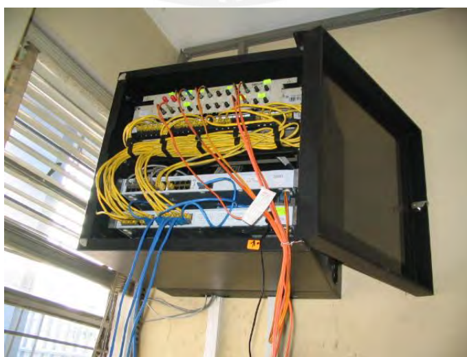
Figura 1.3 Dos conmutadores de la marca 3COM usados por Dpto. Informática
