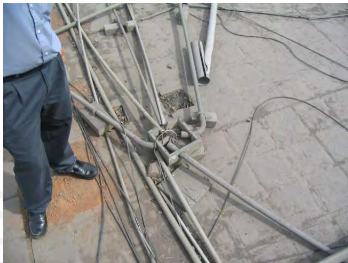
Figura 1.5 Estado de la distribución de cableado UTP sobre el techo del edificio
