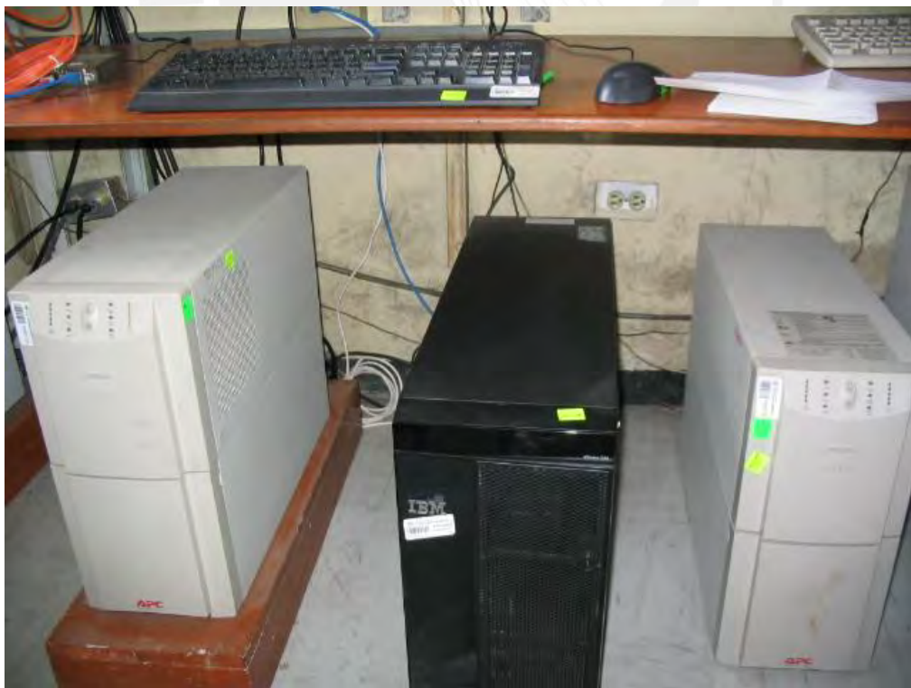
Case del Servidor colocados en su interior se encuentran las tarjetas de los servidores.
