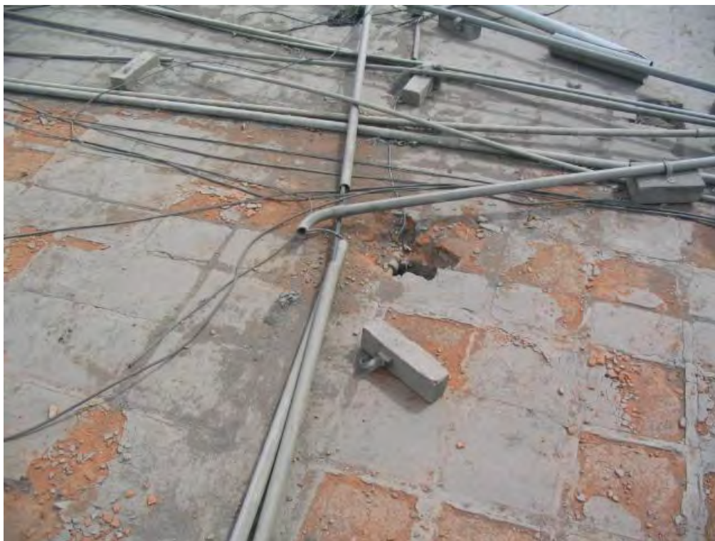
Estado de las 2 ramas que van sobre el techo del departamento de Asistencia Social
