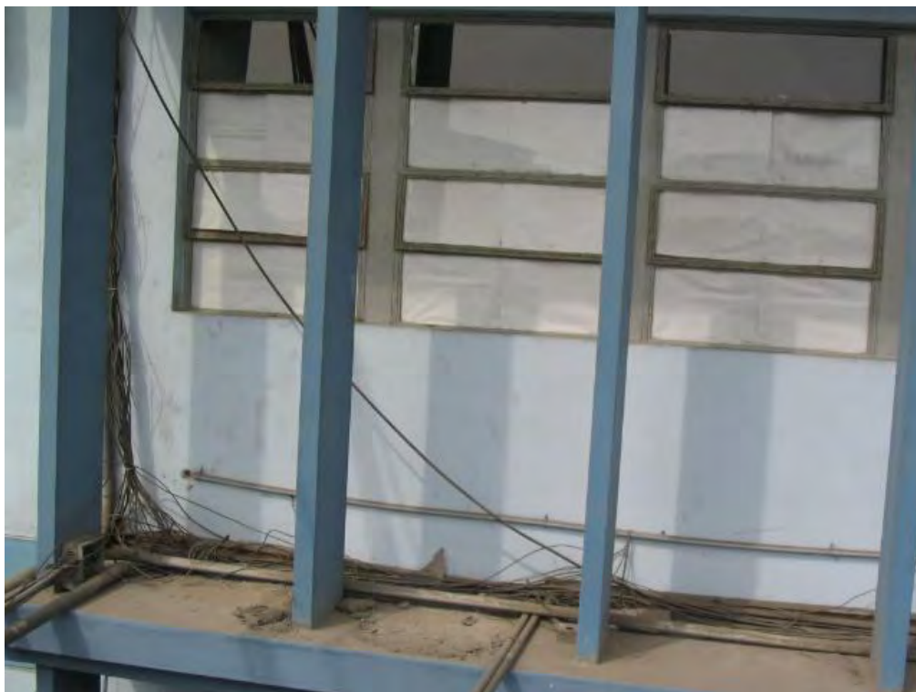
Descripción del cuidado de los cables tendidos y fibra optica que salen desde el actual centro de cómputo
