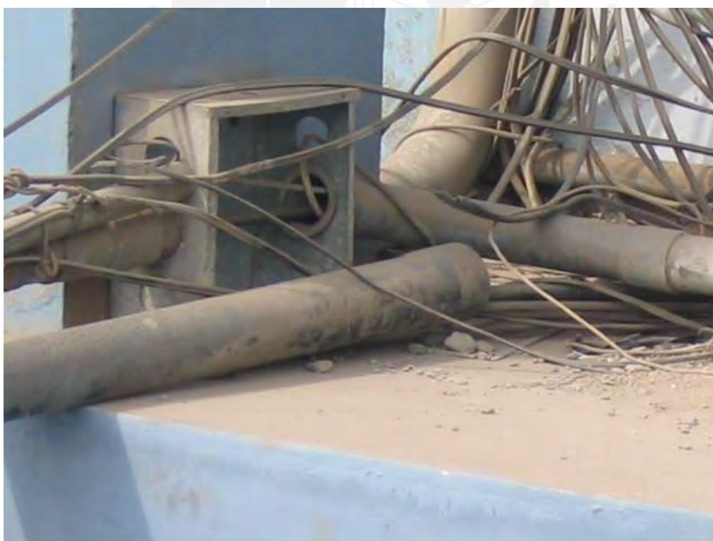
Caja de paso para fibra óptica y cable UTP desde informática
