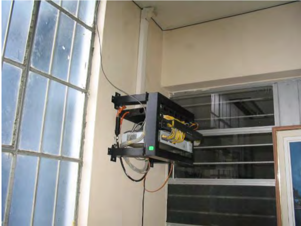
Switch 3com del Dpto de Enfermeria
