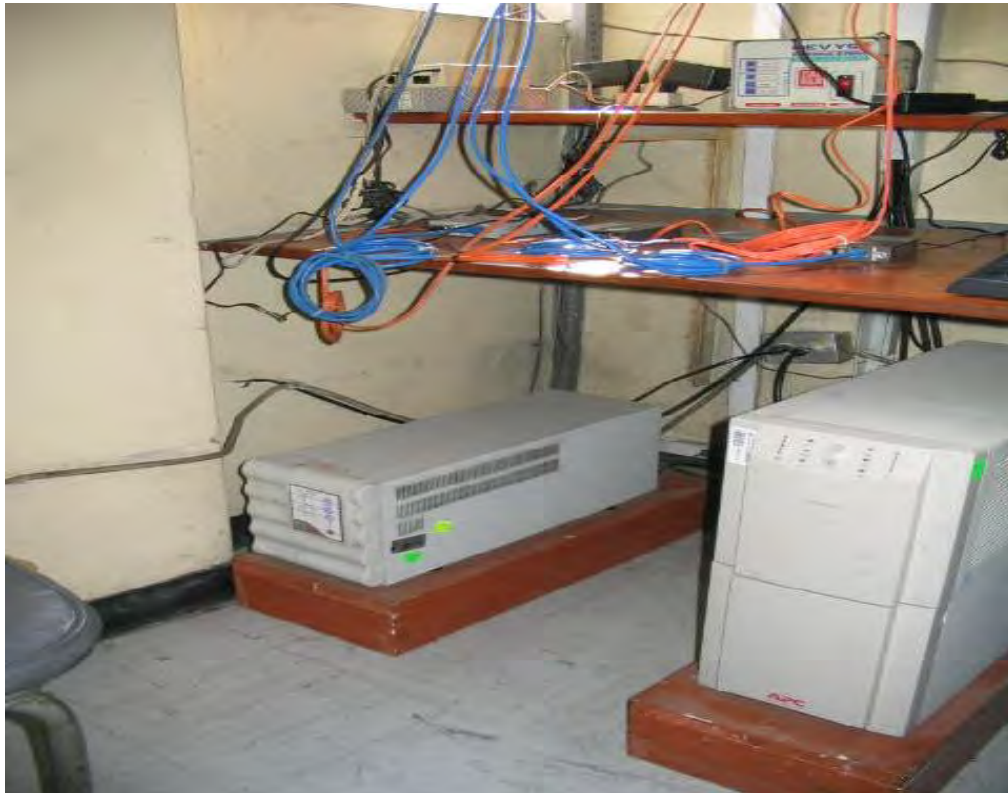
UPS para los switches (la mas pequeña) y UPS para los servidores
