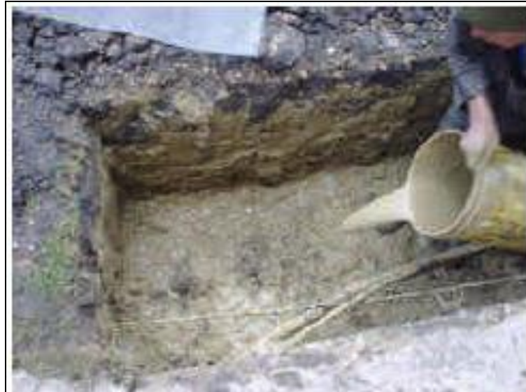
FIGURA 4.12 - Ejemplo de Instalación del Sistema de Puesta a Tierra
