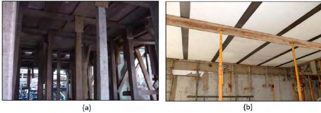
Ilustración 55. Fotografías de comparación de encofrado entre el sistema convencional y el vigacero (Arcotecho techos auto soportados, 2018)
