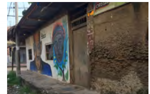
12. Vivienda de tapial en malas condiciones
