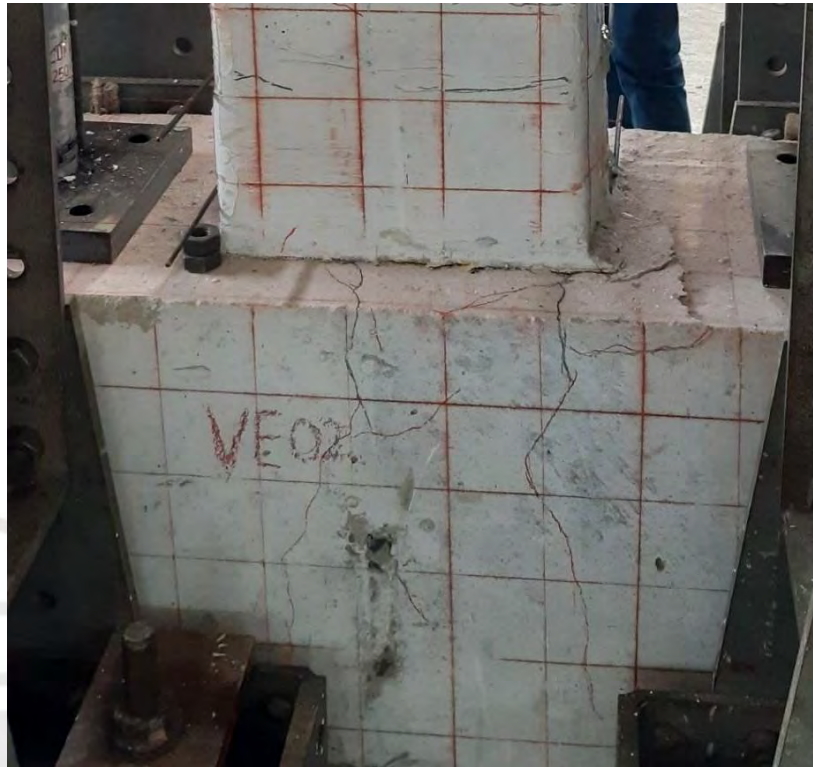
Figura 5.16. Ruptura de la base de empotramiento de VE-02 (Fuente: Propia)
