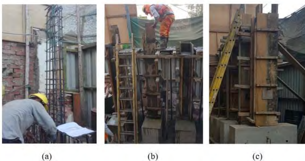
Figura 4.8. Culminación de trabajos de vaciado de concreto f'_c 210 \text{ kg/cm}^2 . (a) Armado de acero de viga, (b) Vibrado de concreto, (c) Finalización de trabajos. (Fuente: Propia)
