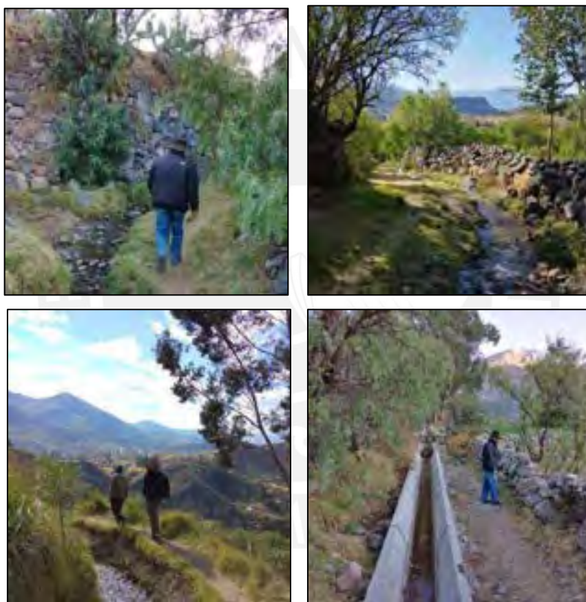
Ilustración 60. Caminos de vigilancia al lado de canales de agua, cuya función es para el tránsito de personas Foto. Ampuero, 2019
