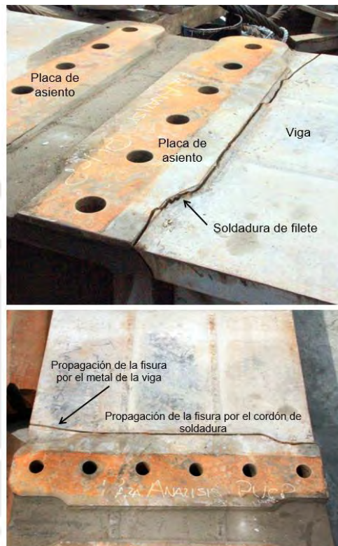
Figura 37. Imágenes de la fisura transversal en la viga.
