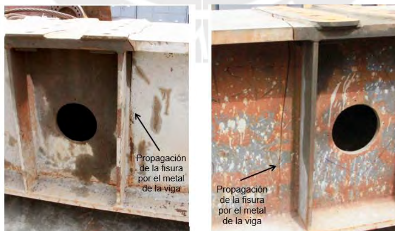
Figura 38. Imágenes de la fisura en las paredes laterales de la viga.
