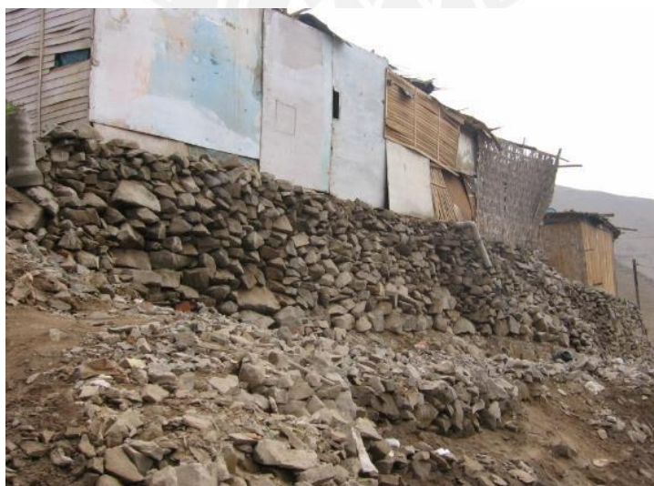
Figura 5. Pirca informal sin junta entre bloques. Fuente: Roca (2008)
