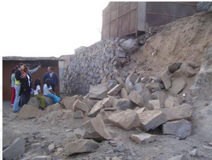
Figura 6. Colapso de pirca en AA.HH Siglo XXI en San Juan de Lurigancho. Fuente: Runa (2007)
