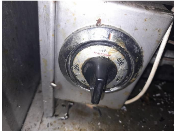
Figura 28 Exceso de grasa en la manecilla de la freidora
