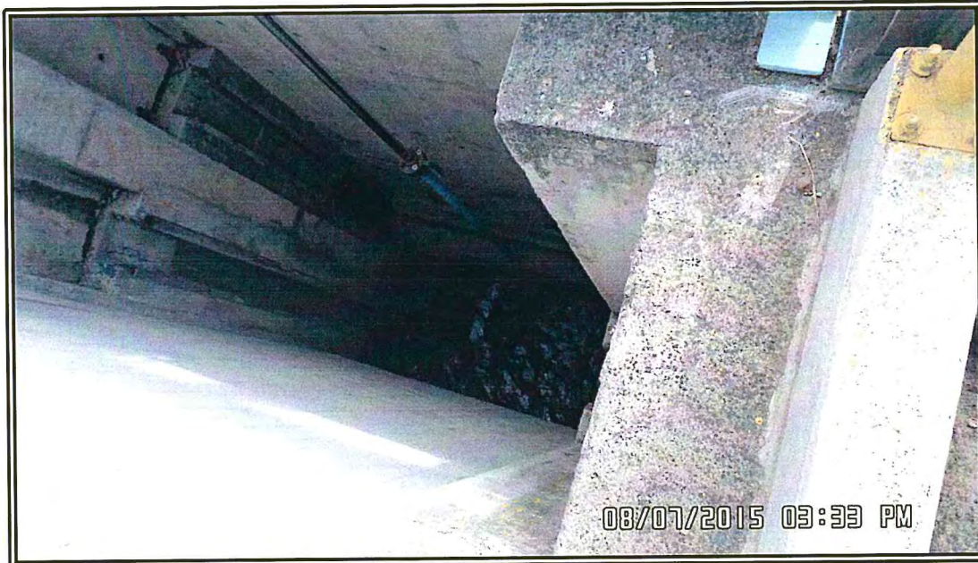
Fotografía 4. Compuerta de aguas turbinadas, regula el paso de agua hacia la C.H. Caña Brava.
