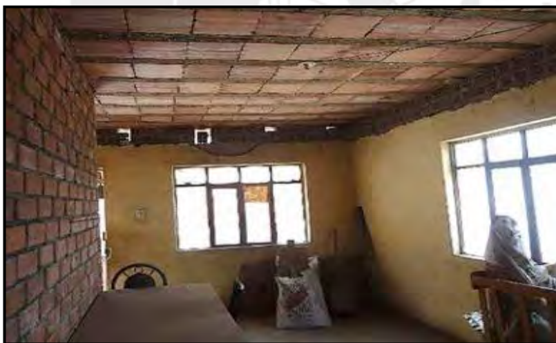
FIGURA 66: Mala praxis de construcción en vivienda
