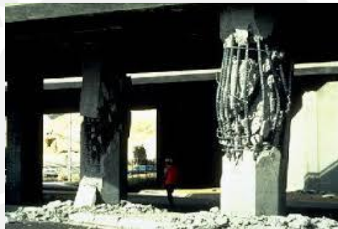
Figura 2.1: Fallas en las columnas de un puente después del terremoto de 1971 en San Fernando, California.
