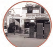
Comercio. La mayor parte de locales son infraestructura deteriorada y autoconstruida, no apta según las normas de edificación.
