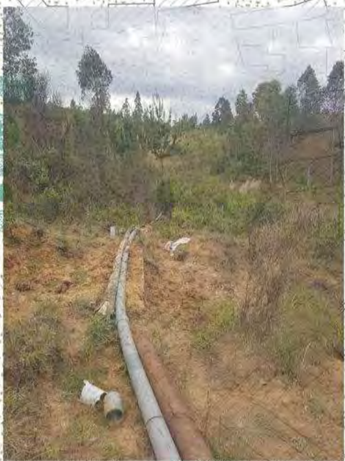
Tubos para canalizar el agua los manantiales para uso doméstico y en las chancherías.
