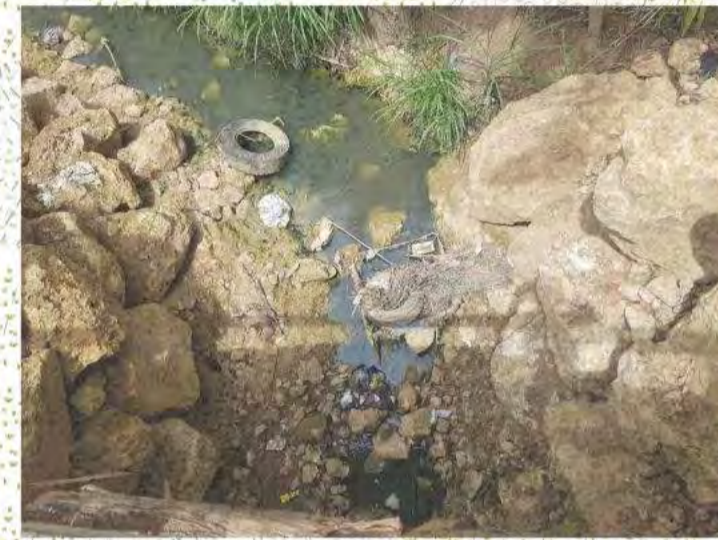
Contaminación del agua bajo el puente. Agua estancada por la erosión del suelo.
