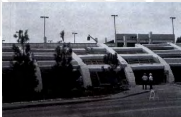
Figura 3-21 Colapso del edificio de estacionamiento CSUN. Iverson y Hawkins (1994)
