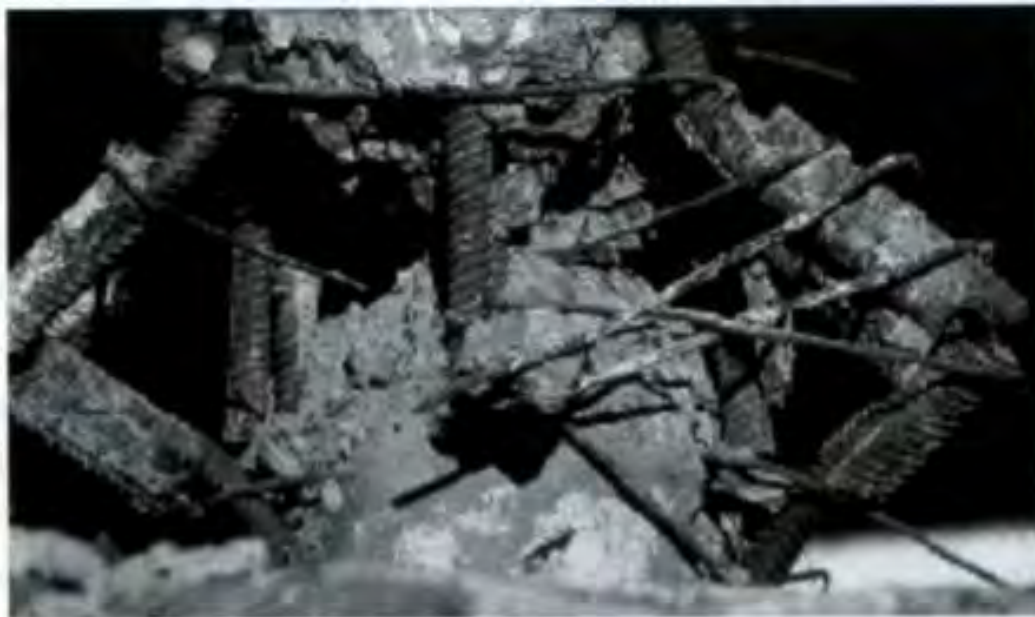
Figura 3-20 Falla en zona de soldadura para traslape de acero. (Fintel, 1994)
