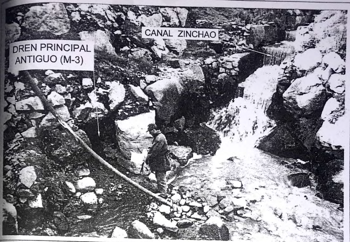
Instalaciones a utilizarse. Canales de drenaje en la confluencia de las aguas de la quebrada de Sinchao y Tres Amigos, para formar la quebrada La Eme, ubicada aguas abajo de la Pila de Lixiviación.
