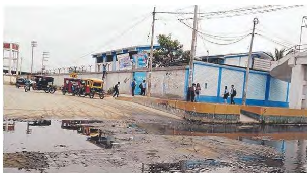
Figura 5.26a Colapso de aguas servidas en el Barrio San José, y junto a un centro educativo el 14/07/2019. Fuente: Diario Correo 2019f.
