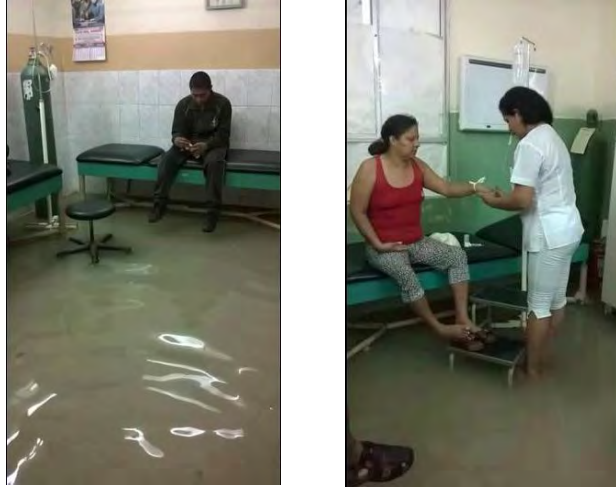
Figura 3.26c Afectación a la infraestructura de salud. Los centros de salud de Tumbes debieron atender inundados por las lluvias producidas por el Niño Costero 2017. Fuente: Peru.com 2017.
